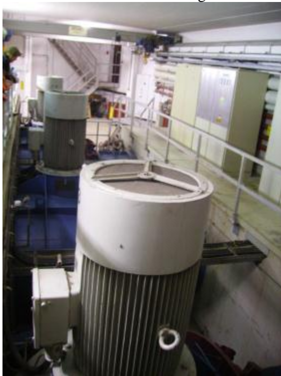
Generatoren im Wasserkraftwerk
