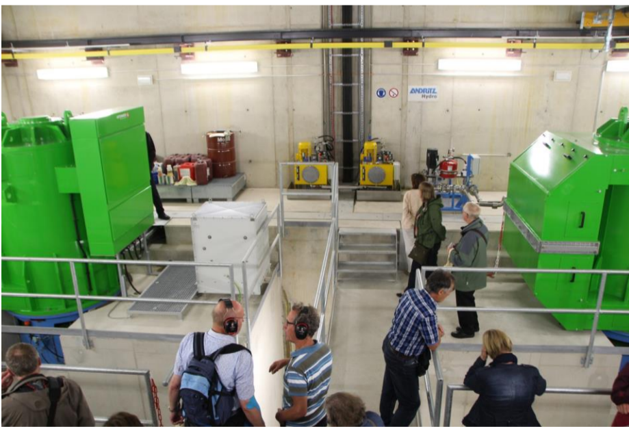
Abb. 4. Maschinenhalle des Kraftwerkes Hochablass
