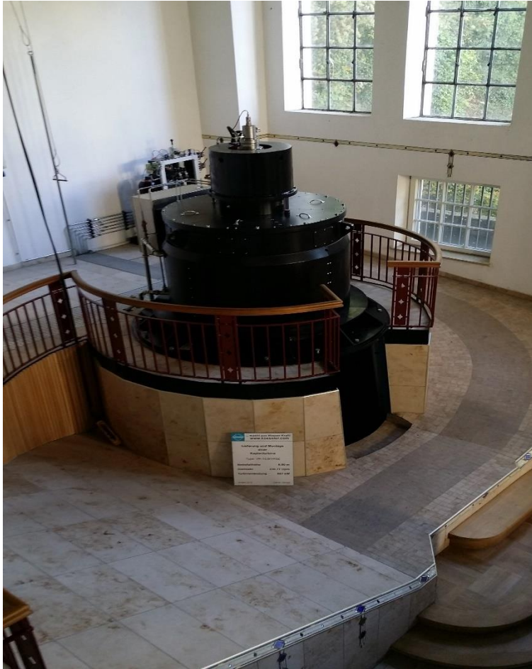
Abb. PM-Generator Foto: Elger
